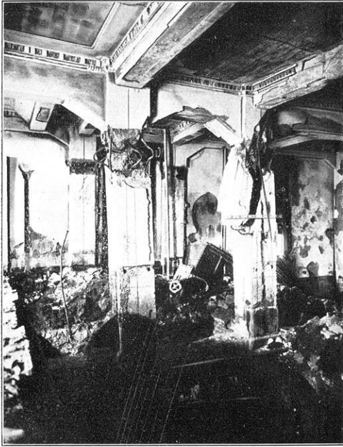
Fig. 7. Yokohama, Fifteenth Bank: Zerstörung an den Köpfen von Eisenbetonsäulen infolge unzureichender Seitensteifigkeit der Skelettbauweise.
